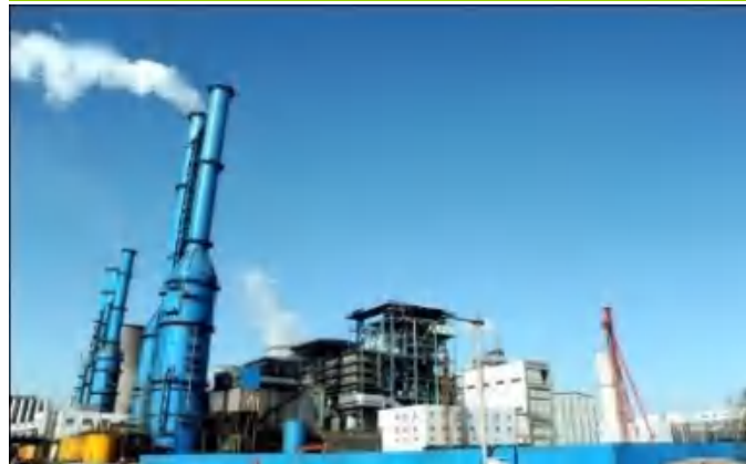
锅炉烟气超低排放
